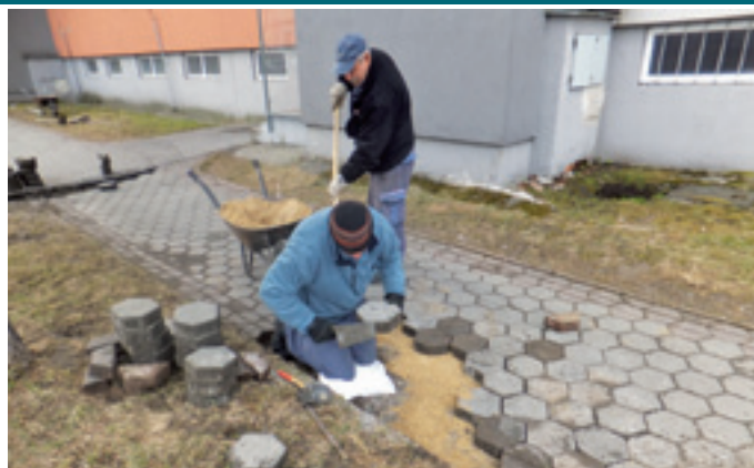
potrebná rekonštrukcia a úprava chodníka foto: MM
