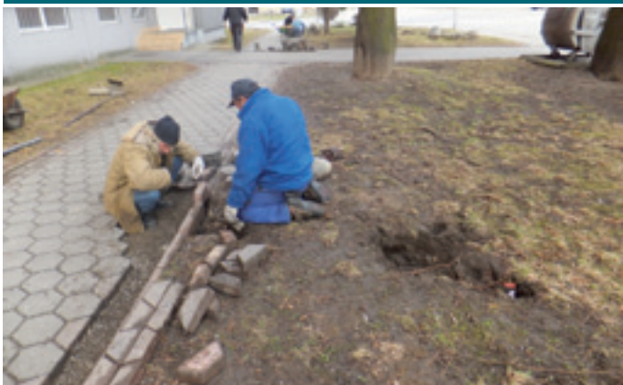
poškodený chodník na Ul. sv. Cyrila a Metoda
