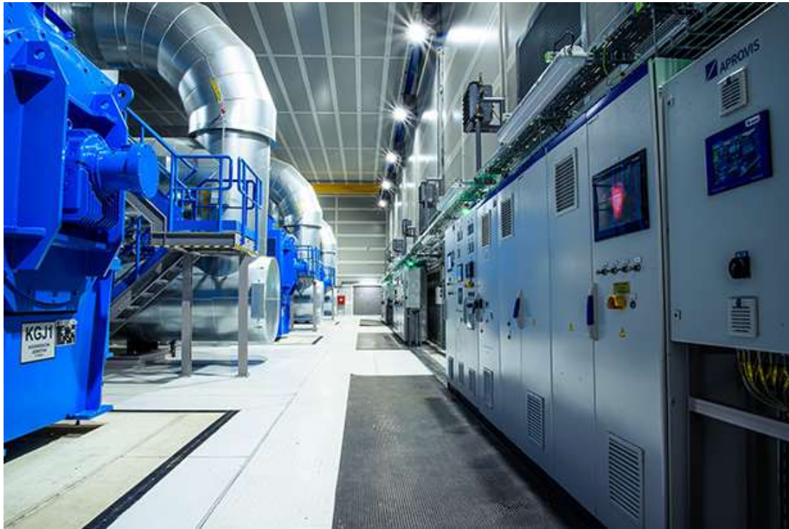
Kogeneračná jednotka KGJ1, Zdroj: Martinská teplárenská, a.s.
